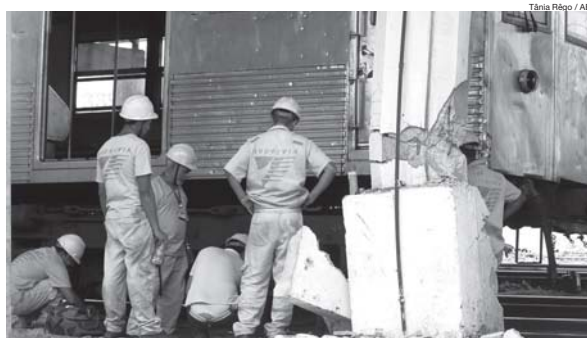
Logo depois do acidente, operários da Supervia trabalham para consertar o vagão
